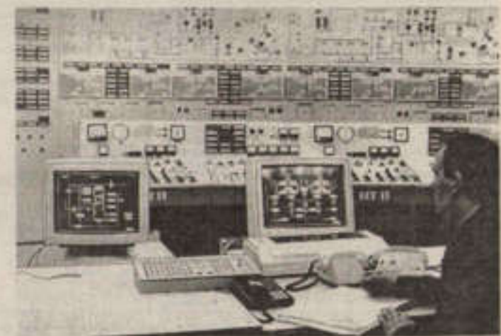
Рис. 3. Блочный щит управления Кольской АЭС. АРМ начальника смены очереди.
